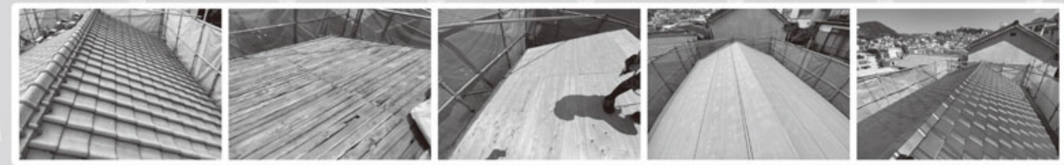
葺き替え 施工前 瓦とルーフィングの撤去 野地板増し張り 下葺き材(ルーフィング) 完成(防災瓦)
